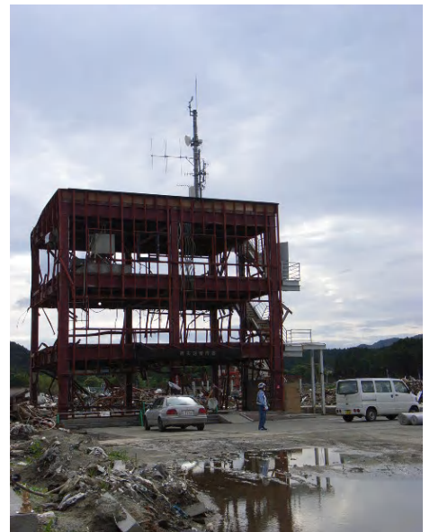
屋上より上まで津波が来たという 3F建ての防災対策庁舎
